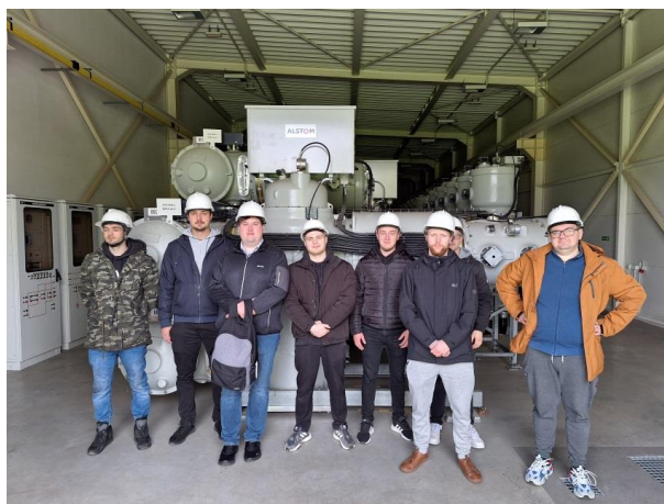
Fot. Studenci Wydziału Elektrycznego w rozdzielni 20 kV.
